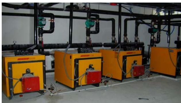
Εσωτερική άποψη ημιυπόγειου (λεβητοστάσιο)
